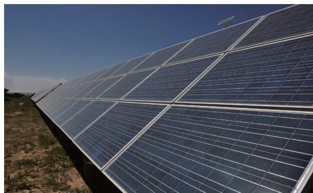
黄河公司安装在中国青海省格尔木300MW的电站已使用杜邦光伏材料。
